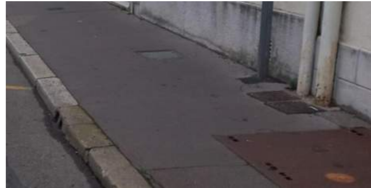
Figure 1 : Photo de deux gargouilles sous trottoir rue Chanzy – Source : ENDURANCE
